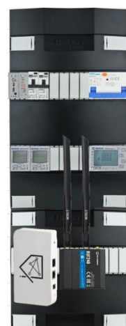
Figuur 6 - Monitoringskast voorbeeld 3 incl. aardlek-automaten
