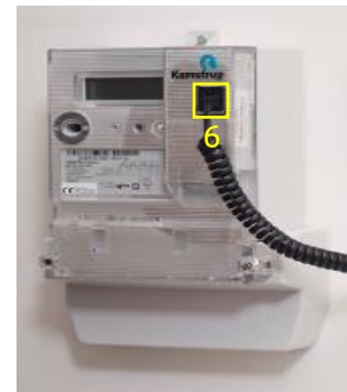
Figuur 3 - Slimme Meter met kabel naar de Gateway
